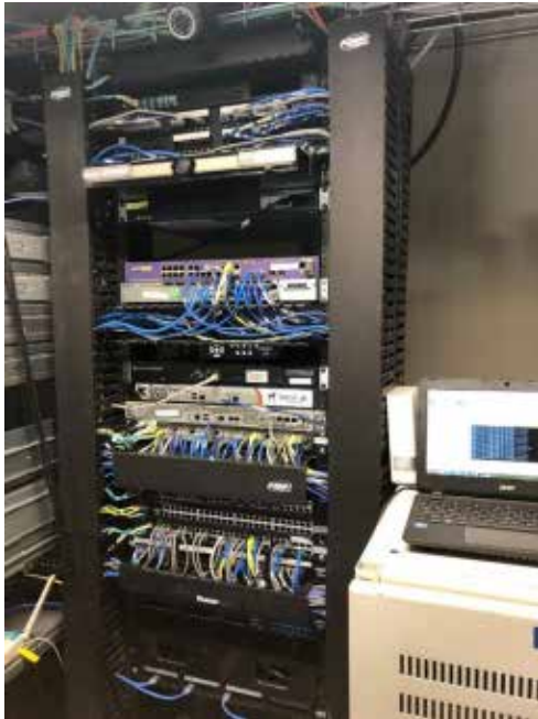
Rack de SITE Edificio A, Antes.
